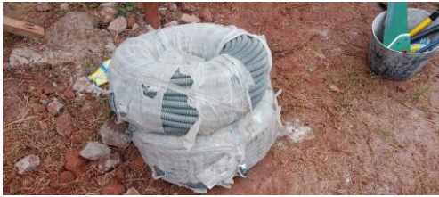
Photo 3 : Tuyaux en rouleau pour passer le courant électrique
